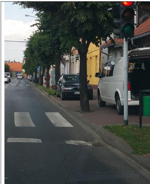
Zapadnięcia kraterów kanalizacji wód opadowych w Rogoźnie ul. Wielka Poznańska - 30.07.2019r.
