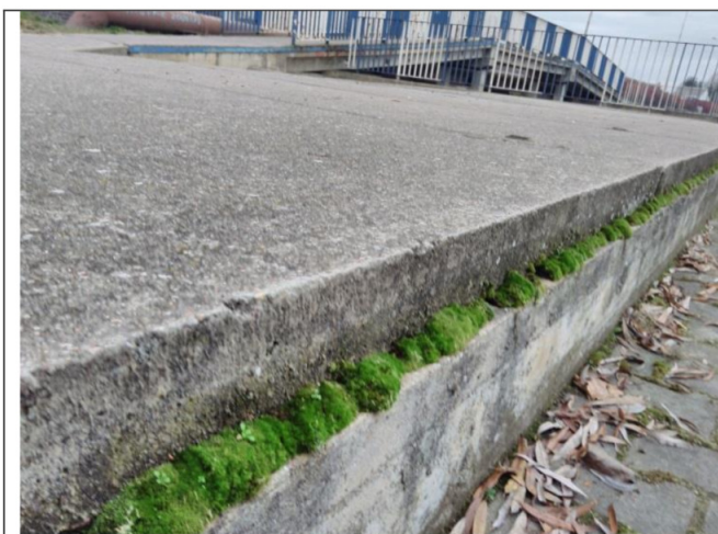
Pokrywa piaskownika przy ujściu Jeziora Rogoźno do rzeki Wełny jest zarosnięta mchem. Stowarzyszenie Jezioro Rogozińskie prosi o udostępnienie dokumentacji dotyczących eksploatacji tego piaskownika oraz informacji wskazującej na sposób wykorzystania piaskownika dla ochrony środowiska. Data: 30.12.2019 r.
