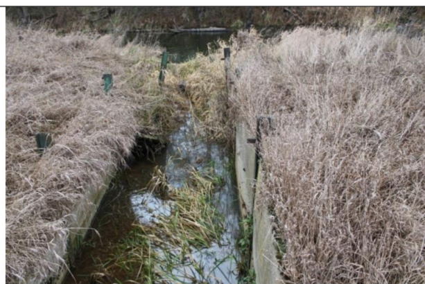
W Rogoźnie znajduje się wiele niezidentyfikowanych obiektów melioracyjnych, które wprowadzają zanieczyszczenia do rzeki Wełny. Przykładem jest poniższy obiekt znajdujący się bezpośrednio przy linii kolejowej Poznań-Piła - Data: 03.01.2020 rok.
