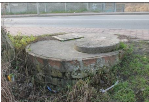
Nieoznakowany obiekt melioracyjny w Rogoźnie na ulicy Lipowej - 02.01.2020r.
