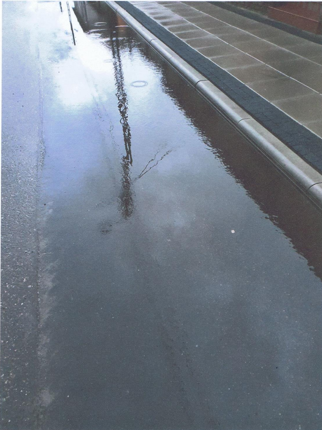
Fot. 1-1. Kałuża na ulicy Mała Poznańska po wykonanych pracach wymiany chodników
